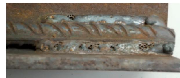
Slechte las in krachtlasverbinding (detail van opname boven)
